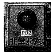
非常押しボタン
