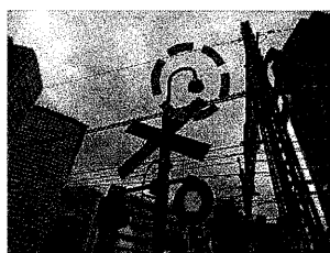
踏切監視用カメラ
