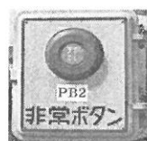
(非常押しボタンの例)
