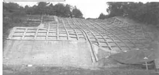
コンクリート枠による斜面の補強
