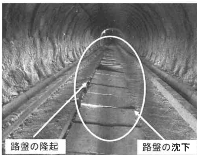
トンネル（先進導坑）の変状
