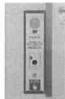
非常通報装置の例
