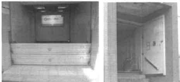
止水板・防水扉の整備
