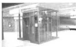
エレベーター
