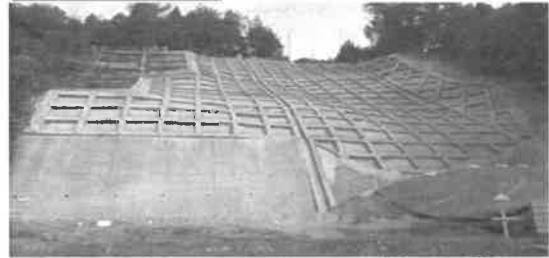
コンクリート枠による斜面の補強
