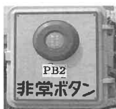
非常押しボタン
