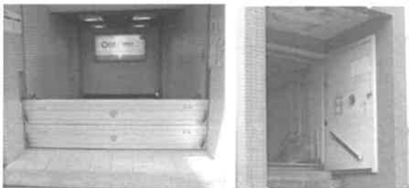
止水板・防水扉の整備
