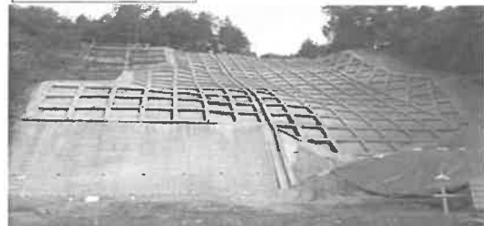
コンクリート柵による斜面の補強
