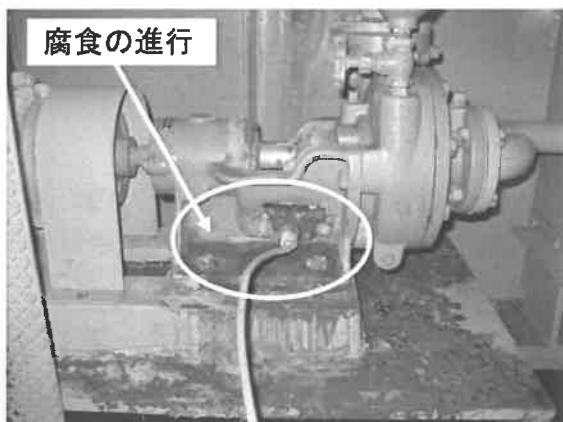
排水設備の劣化
