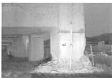
令和4年3月の地震による 新幹線の施設(ラーメン橋台)被害
