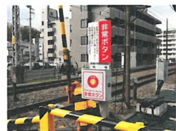
踏切に増設する非常ボタン
