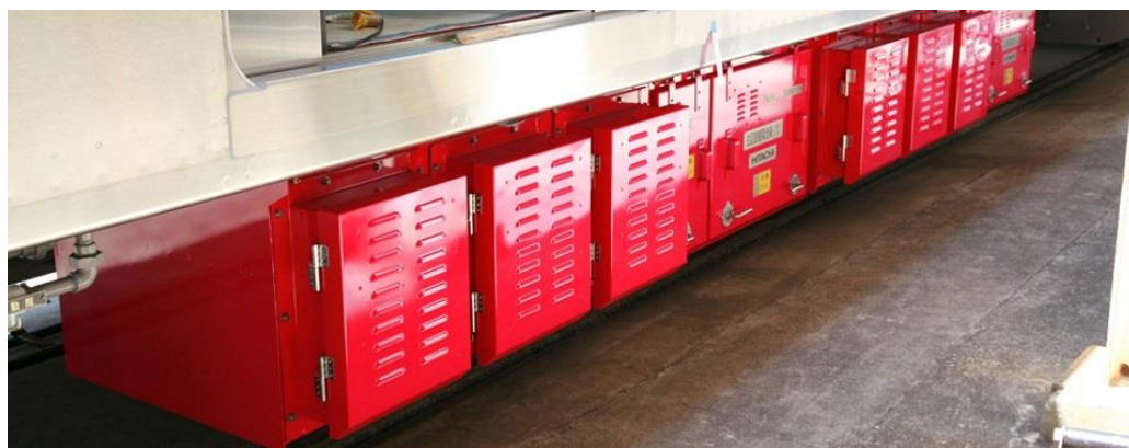
《車上蓄電池の外観》
