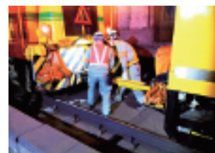
保守用機械の復旧訓練
