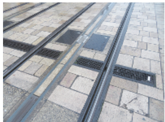
写真-38 トゥールで使用されているAPS地表集電システム。レール間に設置された第三軌条から集電する。ここは絶縁区間で、制御箱(黒い鉄製の蓋部分)が設置されている。(2020年1月30日)
