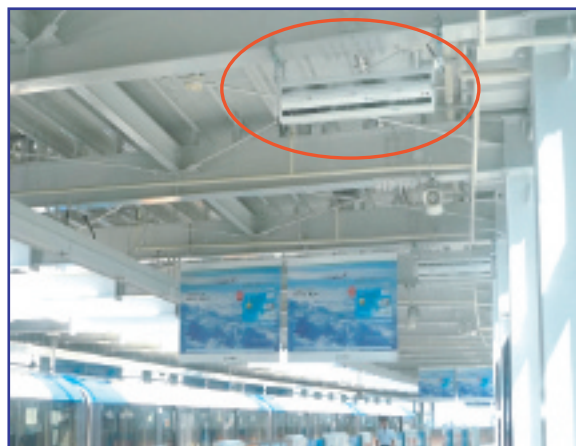
東京モノレール様 羽田空港国際線ビル駅
