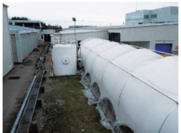
車両基地（洗浄線）
