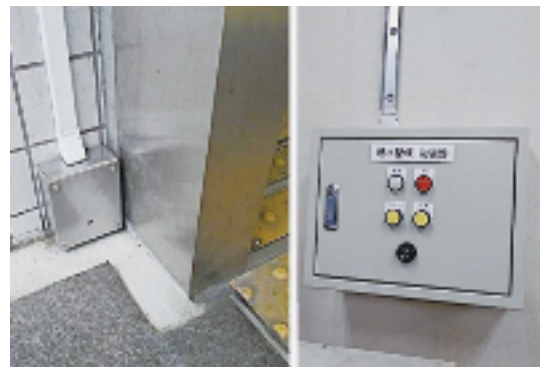
浸水警報装置
