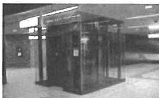
エレベーター
