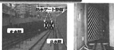
トンネル内防水ゲート
