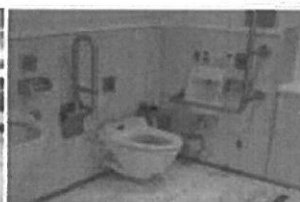
障害者対応型トイレ
