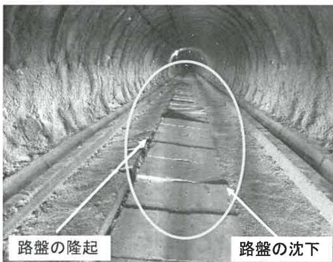
トンネル（先進導坑）の変状
