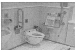
障害者対応型トイレ
