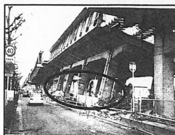
高架橋等が大きく破壊し倒壊する被害が発生
