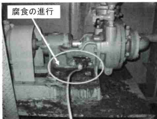
排水設備の劣化
