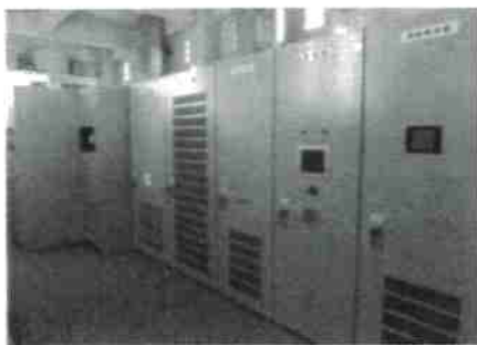
鉄道施設内に設置した電力貯蔵装置
