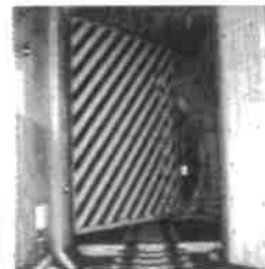
防水扉(トンネル内)
