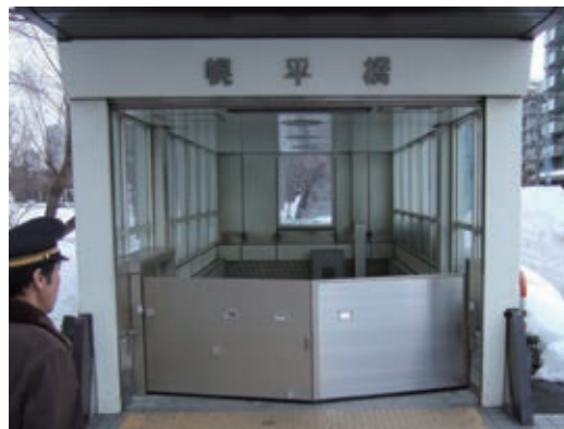
幌平橋駅 止水板
