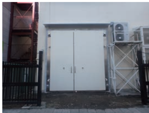
中の島変電所 止水扉
