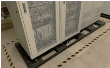
写真2-2 免震装置（装荷）
