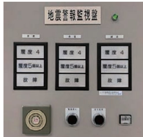
写真3 地震警報監視盤
