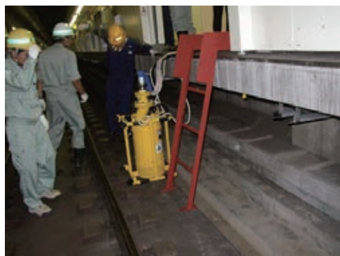
写真7 可搬式ポンプ
