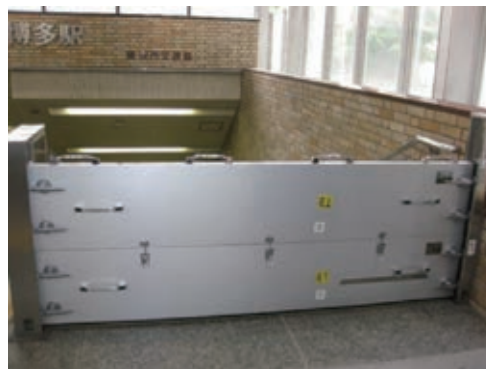
写真5 博多駅の止水板
