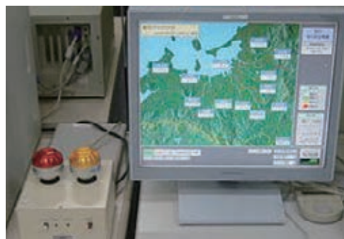
写真6 河川水位警報装置
