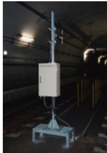
写真-5 送信機 (列車接近警報装置)
