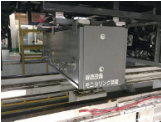
写真-2 軌道変位モニタリング装置
