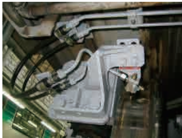
写真-3 塗油装置
