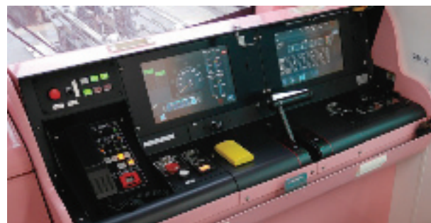
運転台表示画面（車両情報制御装置）
